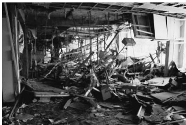
図1 大津波で被害を受けた校舎内の様子
